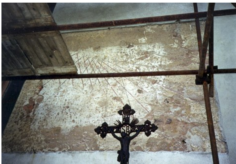
Obr. 151 — Značně poškozené sluneční hodiny na kostele sv. Mikuláše v Horní Branné. Foto Jan Trebichavský (2000).
