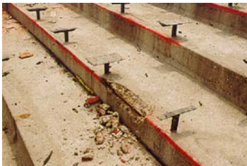
BLEACHER EDGE SPALLS
