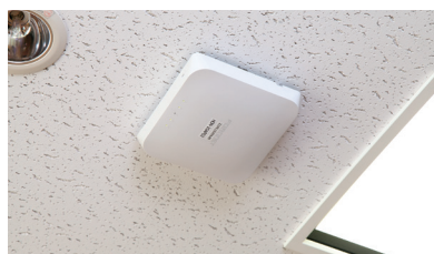
本社の天井に設置されたFortiAP
