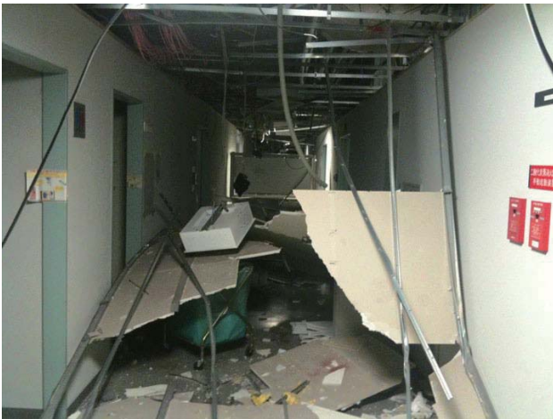
図2 宇宙ステーション運用棟4階の天井崩落の様子
