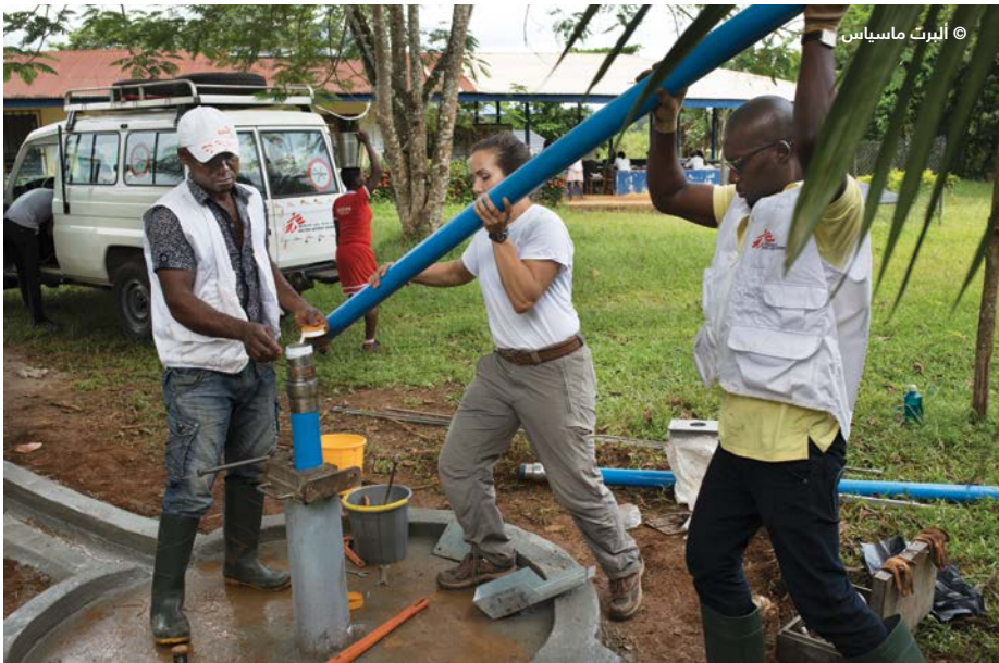
أخصائيو المياه والصرف الصحي التابعون لمنظمة أطباء بلا حدود وهم يركّبون مضخة مياه يدوية في عيادة أبغوكيم في ولاية كروس ريفر. نيجيريا، في نوفمبر/تشرين الثاني 2018.
