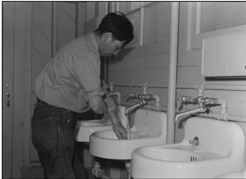
Figura 3-8. Los apartamentos en el edificio de estilo cuartel carecían de plomería interior. Los residentes del campamento utilizaron estaciones de confort ubicadas entre las filas de los barracones Library of Congress, Prints & Photographs Division, FSA-OWI Collection, LC-USF34-073758-D.
