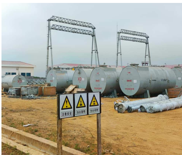
Transformateur de la ZES de Maloukou
