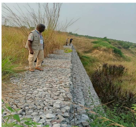
Erosion traitée de kintélé-Pool
