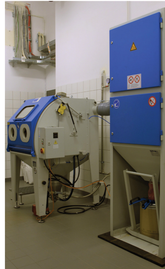
1. Zestaw urządzeń (kabina z filtrem) do obróbki strumieniowo-ściernej.
