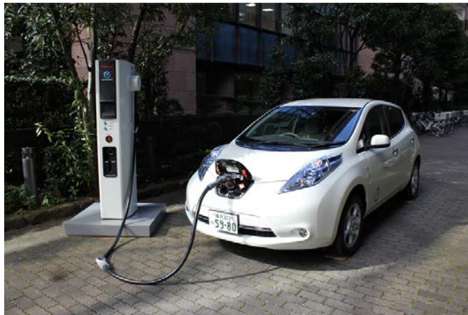
Exemple de punt de recàrrega de vehicles elèctrics
