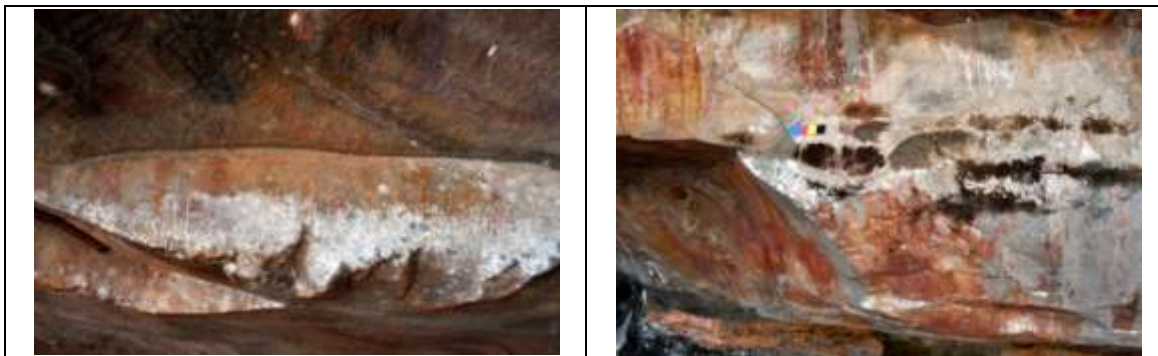
Figuras 18 e 19 – Evidências quanto a necessidade de se aplicar medidas acautelamento e conservação e das pinturas rupestres da área de abrangência.
