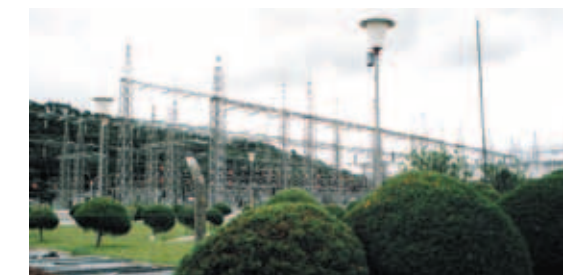
Subestação de Rocha Leão (1996) – Foto: Ricardo Aguiar
